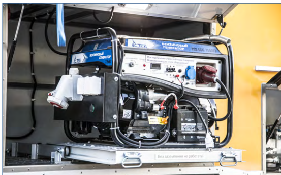
Электрогенератор на выкатной платформе в нише в фургоне.
