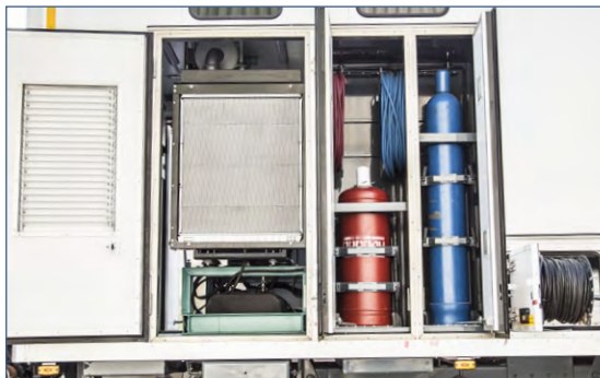
Дизельная электростанция (ДЭС) номинальной мощностью до 120 кВт
