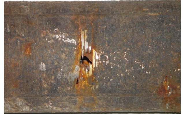
Абразивное разрушение фильтра
