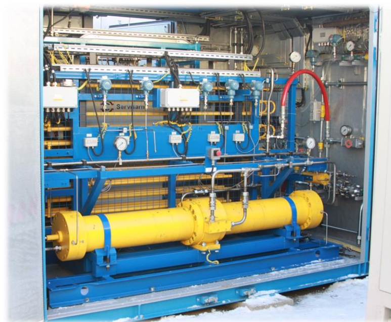
БКПГ с газопоршневым приводом
