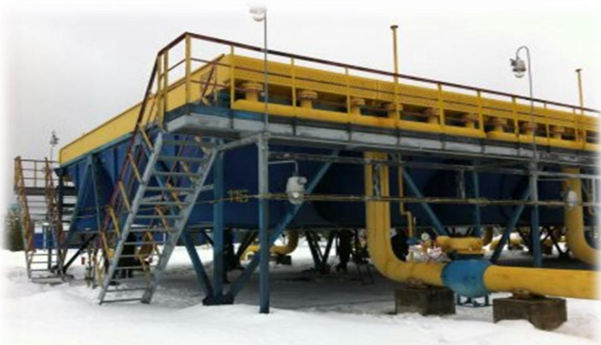
АВГ-85МГ с ЭКД ООО «ГАЗХОЛОДТЕХНИКА» КС «Мышкинская» ООО «Газпром трансгаз Ухта» Приемочные испытания – март 2017 года
