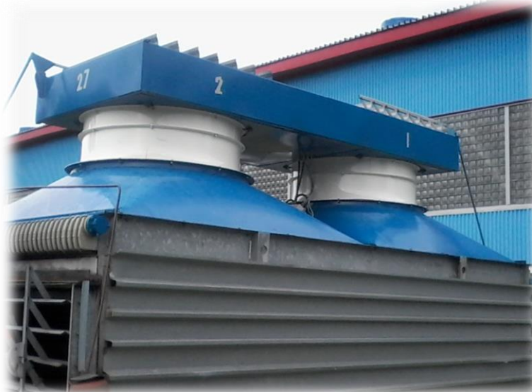
АВО 06-10 с ЭКД ООО «ГАЗХОЛОДТЕХНИКА» КС «Мышкинская» ООО «Газпром трансгаз Ухта» Приемочные испытания – октябрь 2015 года
